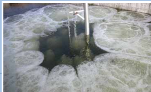
Fasi di avviamento di aeratore sommerso radiale. Starting stages of a radial submersible aerator.
